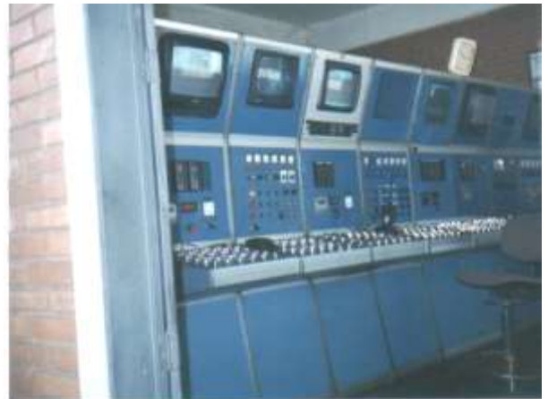
Foto 33: Sala de supervisão da caldeira
