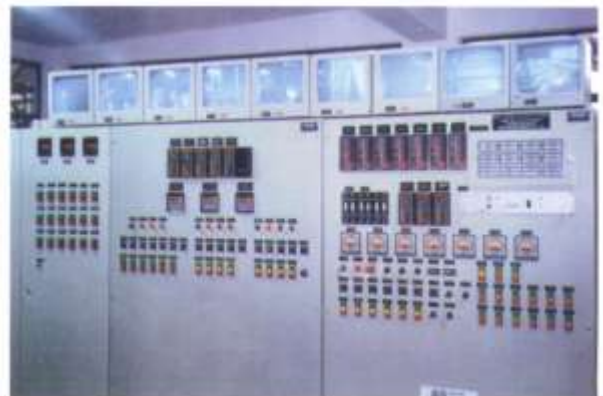
Foto 29: Painel de controle de caldeiras
