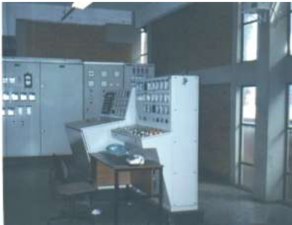
Foto 32: Sala de supervisão dos turbos-geradores
