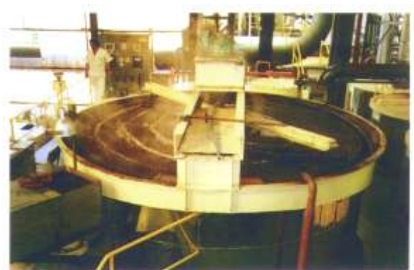
Foto 12: Clarificador na flotação.
