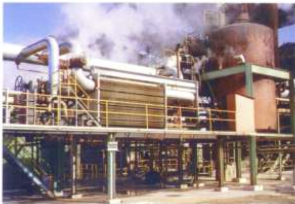
Foto 11: Evaporador à placas
